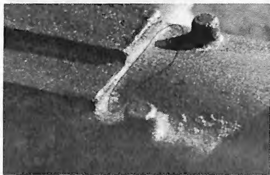
写真5 アクスルハウジングにおける割れ
